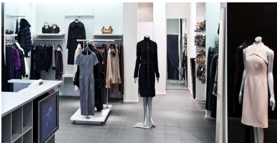
Discrete installation inside a fashion store – Installazione discreta in un negozio di alta moda
